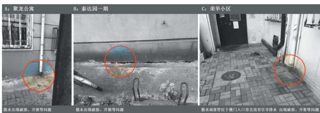
图 3 居住区中散水、雨落管下缘排水中的现状问题
